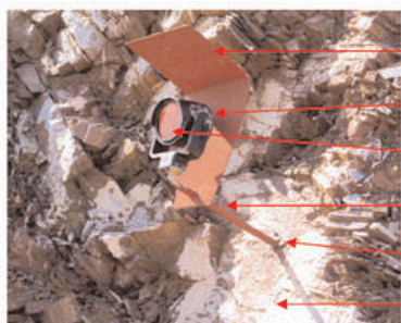
Hình 2.5: Gương được lắp đặt tại điểm quan trắc (Nguồn [12] Thomas, 2011)
